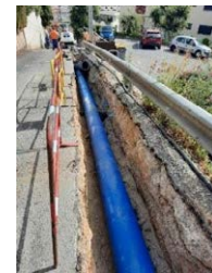
* Travaux de renforcement du réseau d'eau potable Avenue des Caroubiers à Villefranche-sur-Mer
